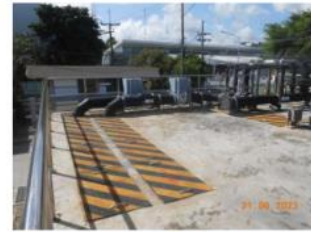
บ่อปรับสภาพน้ำเสียก่อนเข้าระบบ EQ tank
