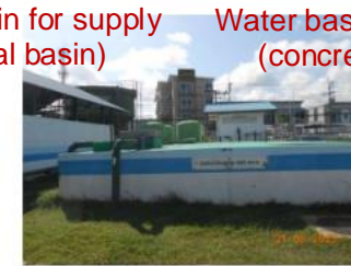
ถังพักน้ำดิบขนาด 200 ลบ.ม. รูปที่ 3.1-1 (15) แหล่งเก็บน้ำดิบของ ททก.
