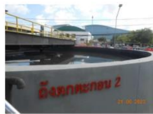
บ่อตกตะกอน Sedimentation tank
